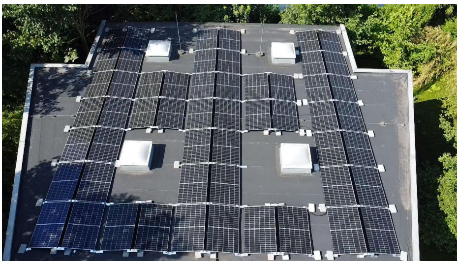
Abb. 9: Photovoltaik-Anlage (54 Module) – Tropenhaus Linzer Tiergarten
